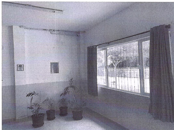
Foto 3: Paredes e teto do pátio interno.
