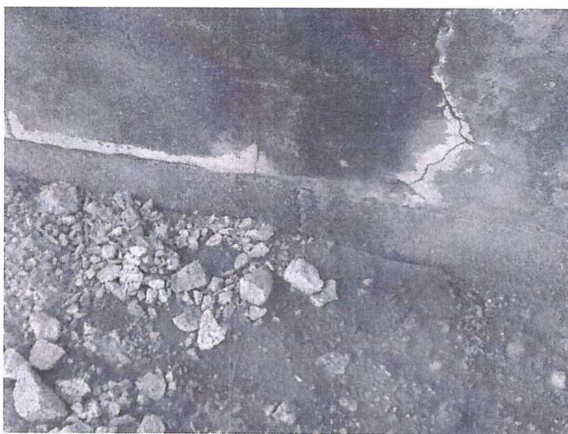
Figura 8: Muro com infiltração.
