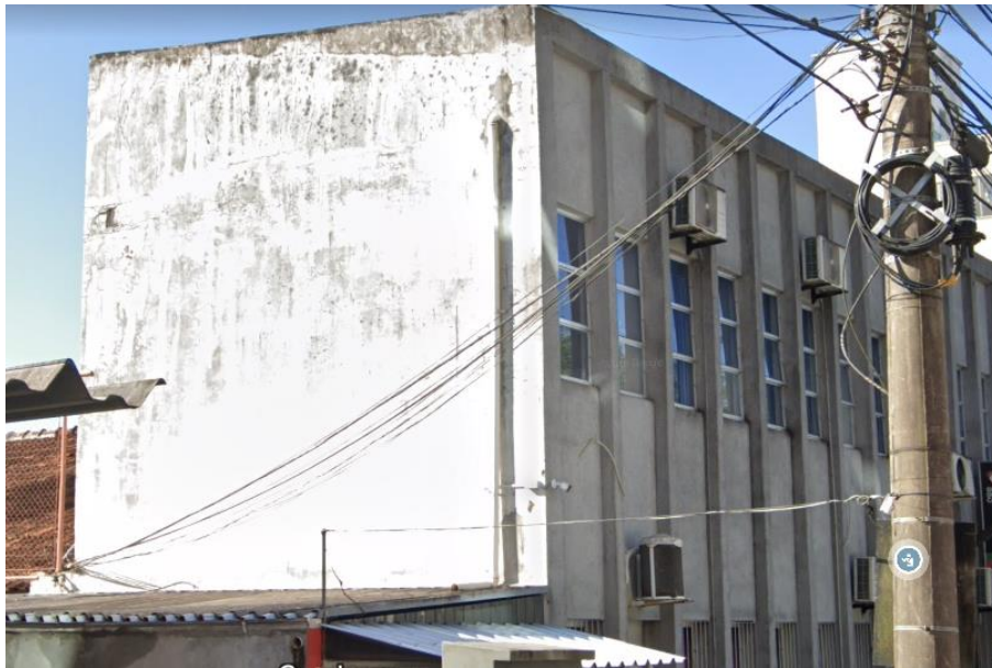
Figura 1 - Patologias em uma das fachadas
