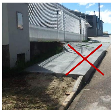
FIGURA 9: CALÇADA IRREGULAR, SEGUINDO A INCLINAÇÃO DO ACESSO E NÃO DA VIA. BIGUAÇU/SC
